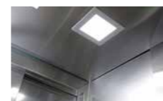
Energiezuinige verlichting en automatische uitschakeling van de cabineverlichting
