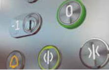
Mise en stand-by de l'ascenseur
